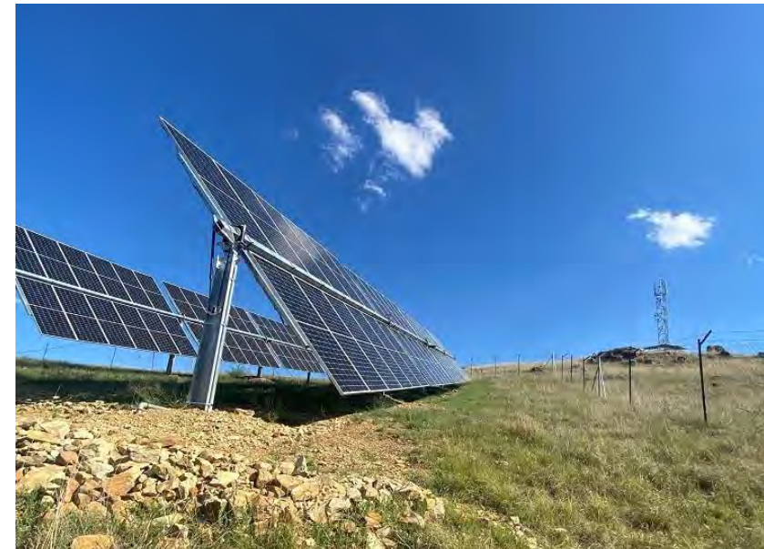
Foto: Ha-Makebe Solar PV mini-grid
